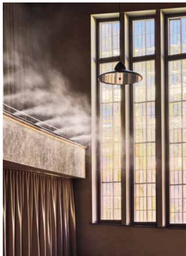
Die auf der Brüstung der Empore montierte Befeuchtungsanlage sorgt dafür, dass die Luftfeuchtigkeit nicht unter 40% sinkt und die sensiblen Instrumente keinen Schaden nehmen.
